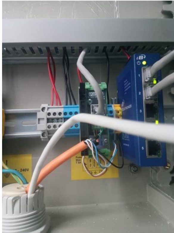
Photo n°10 : Vue du switch défectueux (voyants de contrôle verts)_novembre 2019
